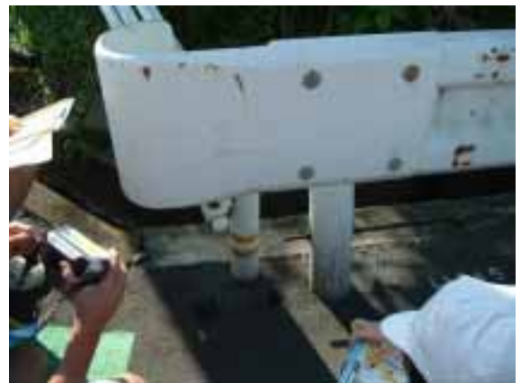
ガードレールの下に、ワイヤーが張られているだけの危険箇所を発見！
